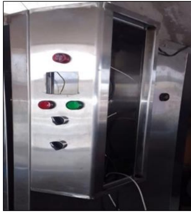
Ilustración 2: Tablero de control.
