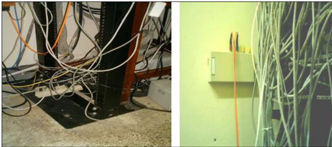
Figura 10. Falta organización de reguladores de energía.
