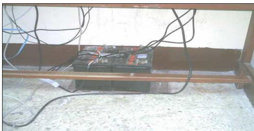
Figura 7. Baterías conectadas al UPS de COOPNO.
