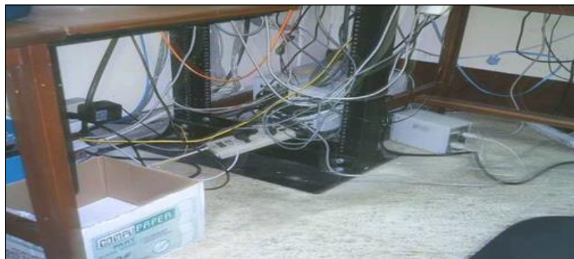
Figura 6. Conexión del ups de COOPNO.
