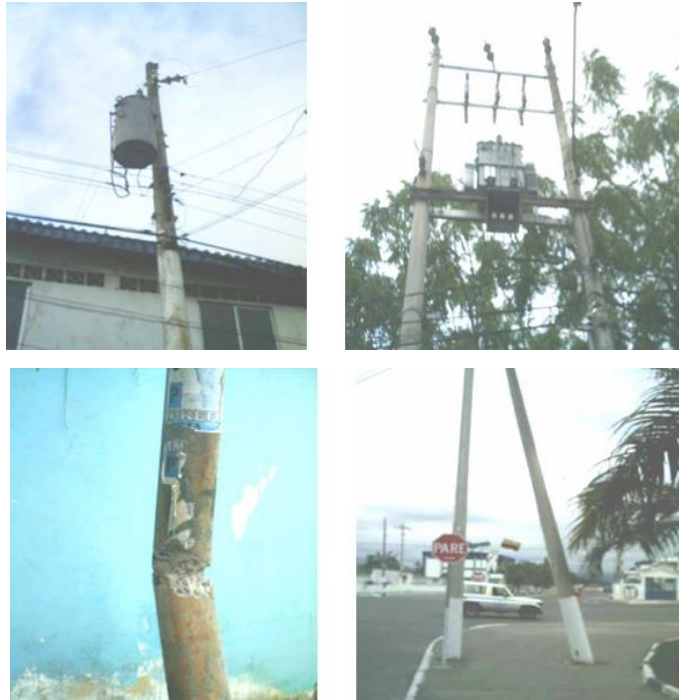
Figura 11. Postes y transformadores de la armada.
