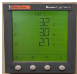
Figura 29: THDi del sistema después de compensar el tercer y séptimo armónico
